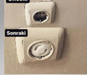
Ortak alandaki prizlere, priz koruyucu taktık
