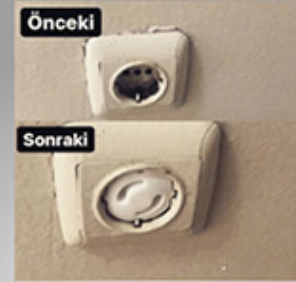
Ortak alandaki prizlere, priz koruyucu taktık
